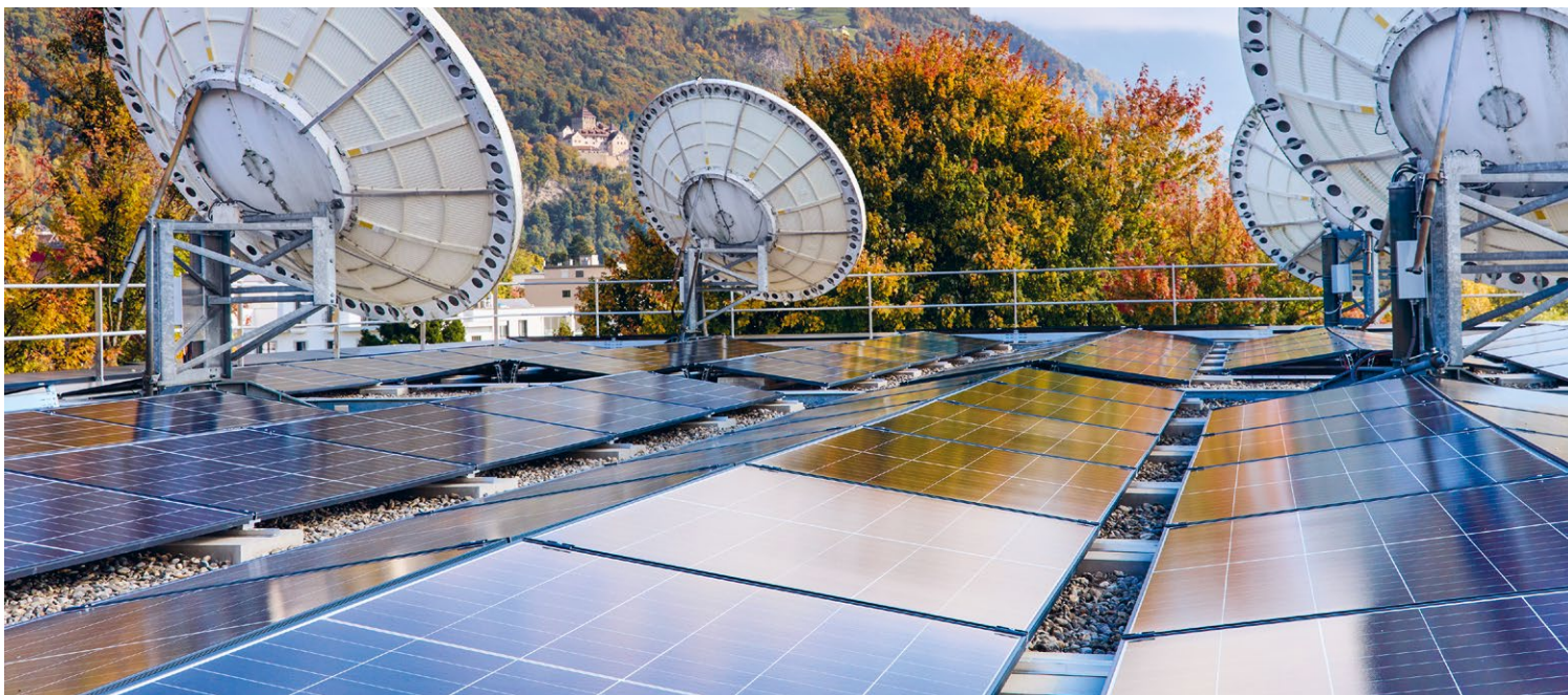
Neu ausgebaute Solaranlage
