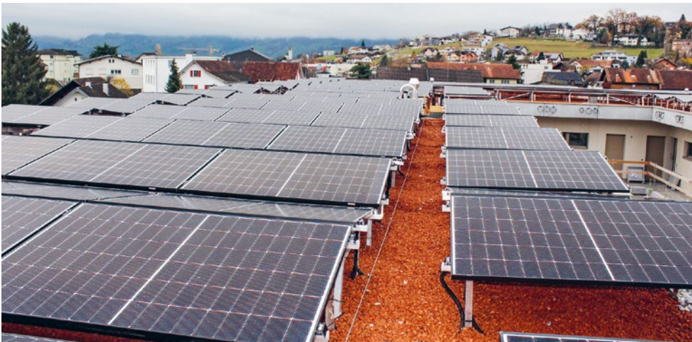
Das Gebäude verfügt über eine grossflächige Dachinstallation einer Photovoltaik-Anlage.
