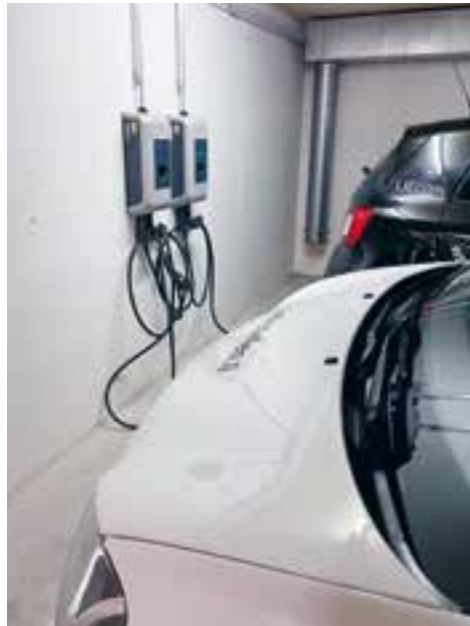
Neu befinden sich in der Tiefgarage der Wirtschaftskammer sechs Ladestationen, wo in Zukunft auch die Besucher ihre Elektromobile laden können.
